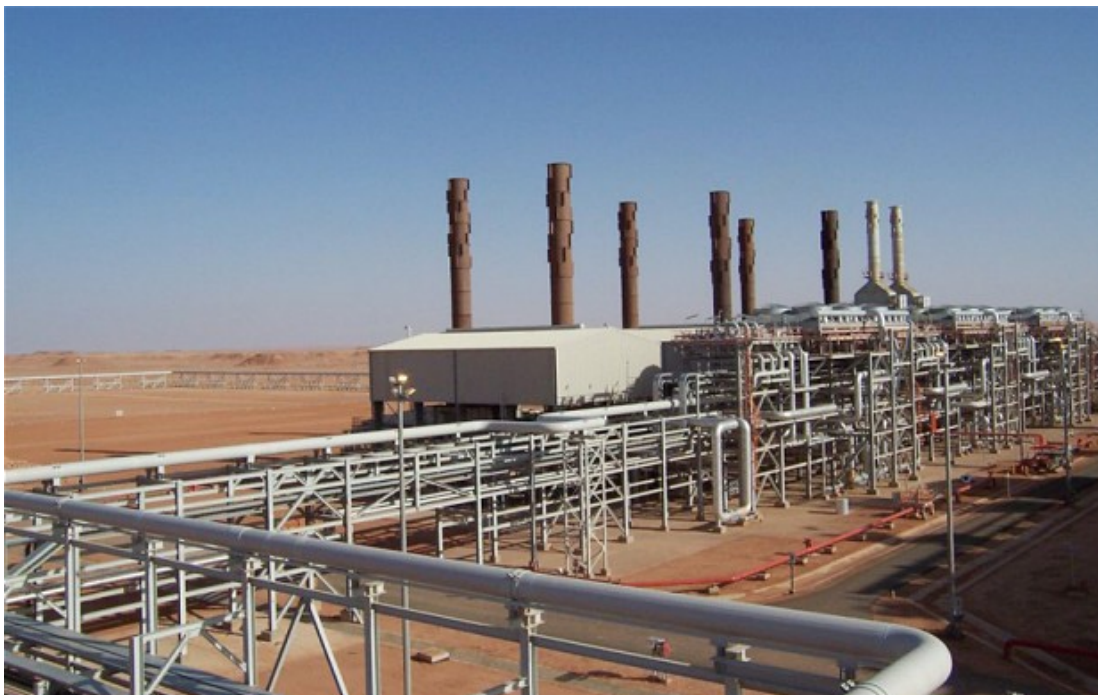
Εικόνα 7: Εγκαταστάσεις παραγωγής του φυσικού αερίου Amenas
