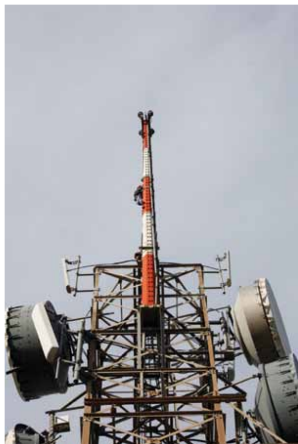
Αναμεταδότες σήματος ΟΤΕ
