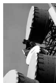
Αναμεταδότες σήματος ΟΤΕ
