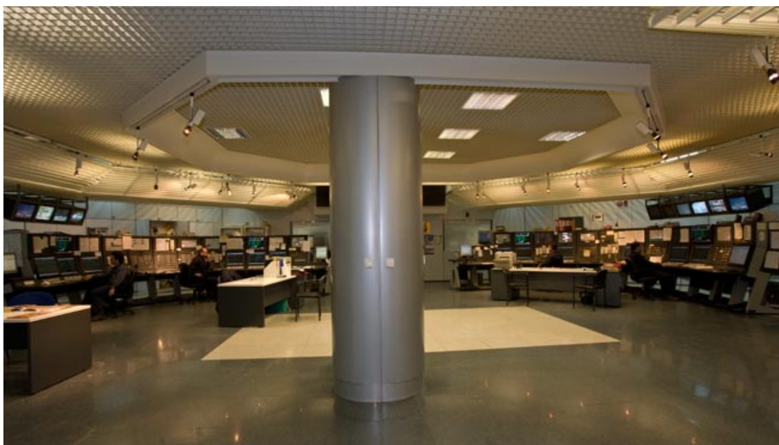
Κέντρο Ελέγχου του Διυλιστηρίου Θεσσαλονίκης
