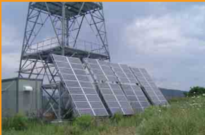
Φωτοβολταϊκό σύστημα σε Σταθμό Βάσης
