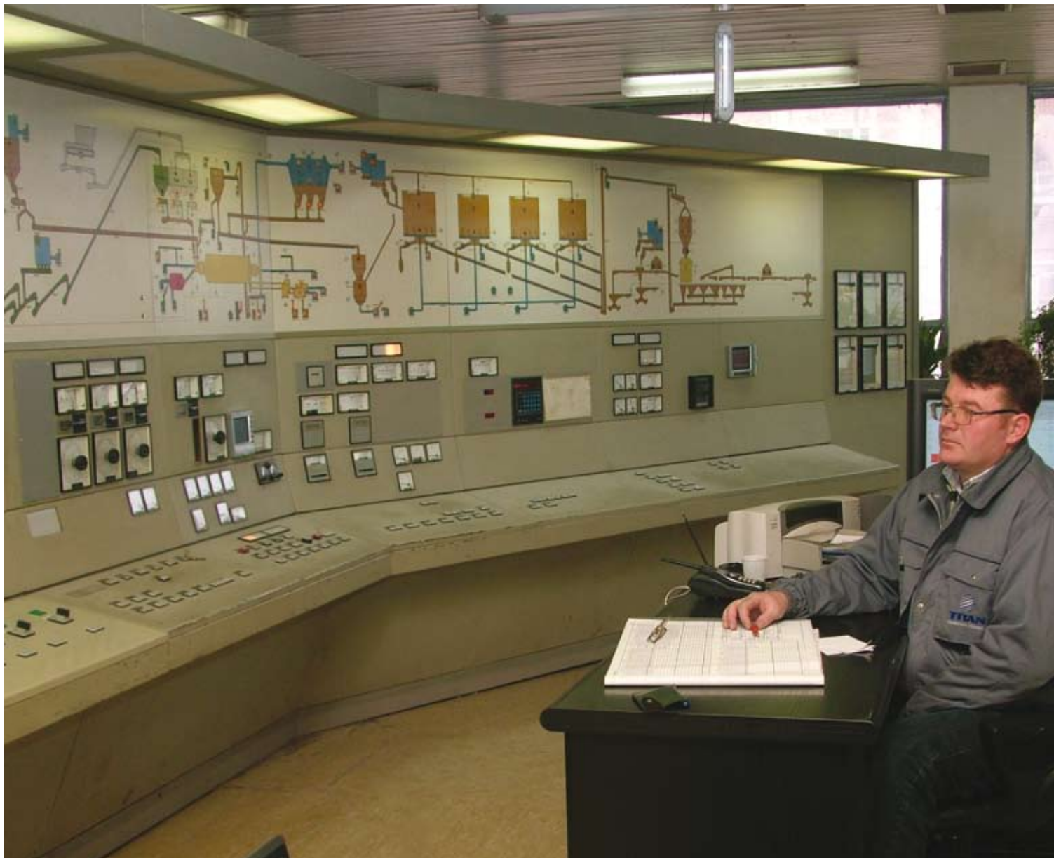
Κέντρο ελέγχου, εργοστάσιο Kosjeric - Σερβία, 2005
